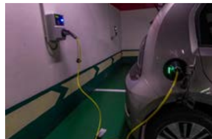
Tomada doméstica (schuko) em estacionamento.
