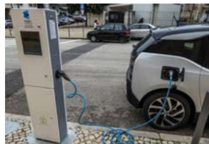
PCN tipo 2, 22kW na via pública.
