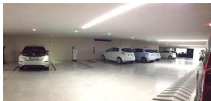
PCN de 7.4 kW e de 22 kW em parque de estacionamento subterrâneo em Lisboa.
