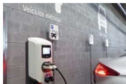
Carregadores de 22 kW no estacionamento do El Corte Inglés e do Ikea, em Lisboa.
