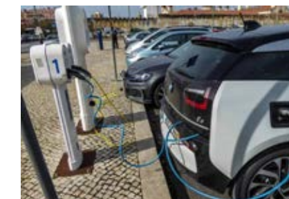
PCN tipo 2 a 3.7 kW na via pública.
